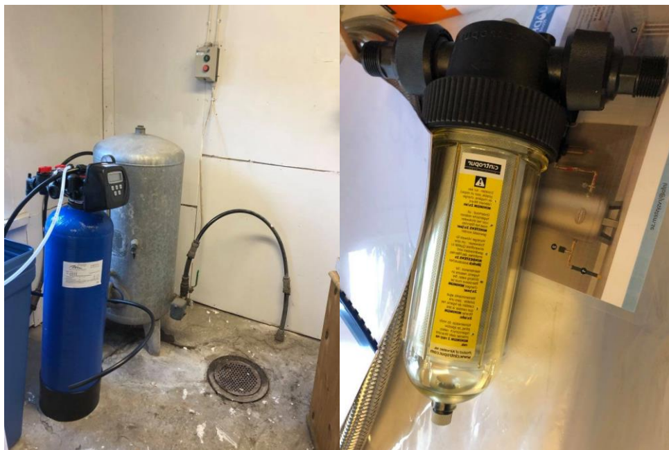
Exempel på installerad reningsteknik.
